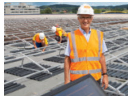
5500 Quadratmeter für Solarstrom: Erwin Stöckli zeigt stolz die grösste Photovoltaikanlage Winterthurs.
