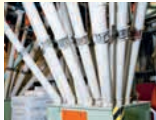
1. Über Verteilungsrohre gelangen die Zutaten in eine grosse Mischmaschine.
